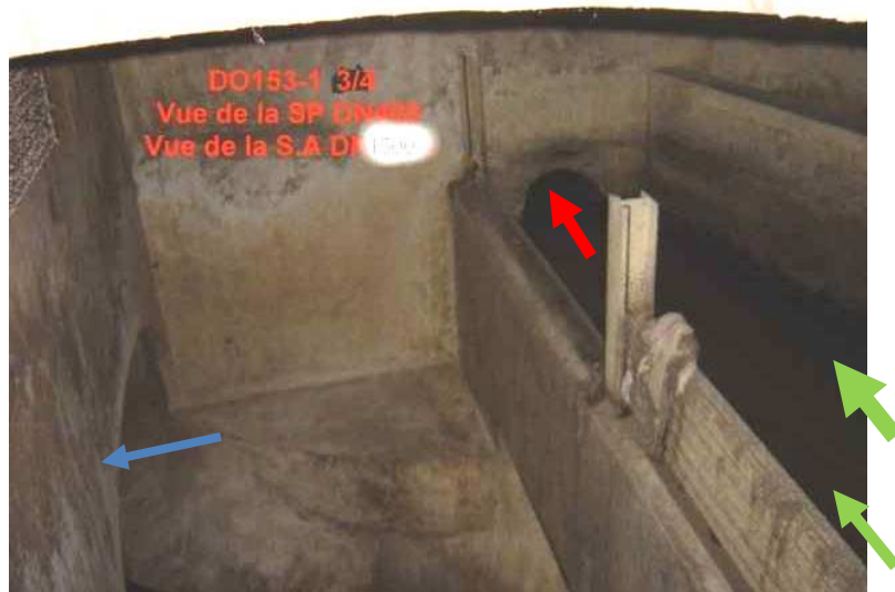
Figure 5. Photographies du déversoir de la Rue du Canal à Souffelweyersheim (Communauté Urbaine de Strasbourg)
